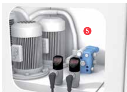
利用 IO-LINK 进行连续压力监测
